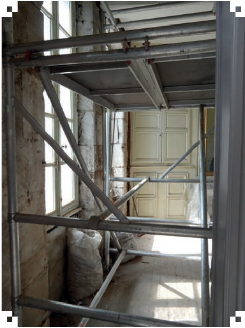
Le salon, au rez-de-chaussée, en danger.
