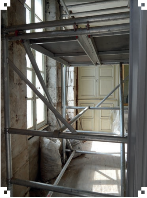
Le salon, au rez-de-chaussée, en danger.
